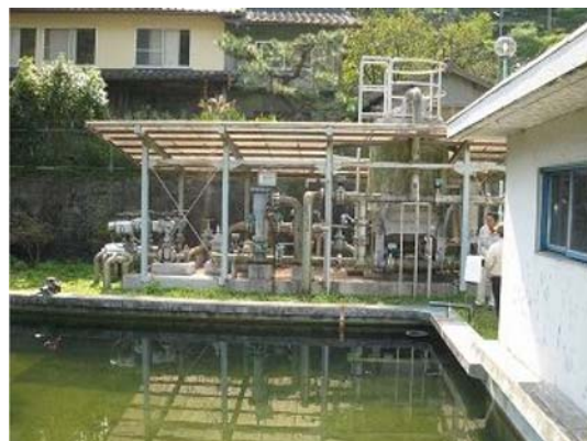
川之内浄水場の前処理設備
