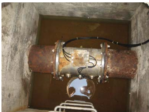
—愛宕第2配水池の配水管ピット内—
