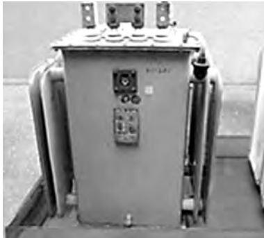
高圧トランスの例
