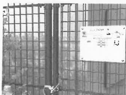
深井戸(消火・生活用水)
