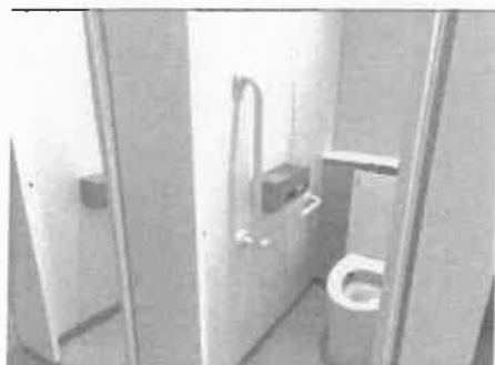
非常用トイレ(断水時使用可)
